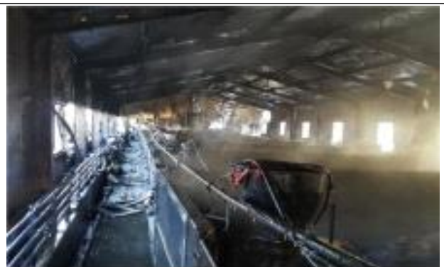
전기 절연불량에 의한 화재
